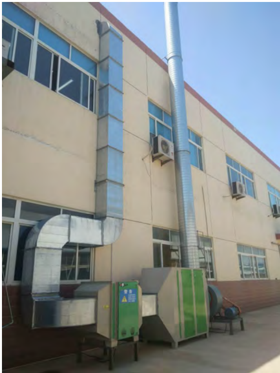
UV 光解+活性炭吸附装置及排气筒 (喷胶干燥工序)
